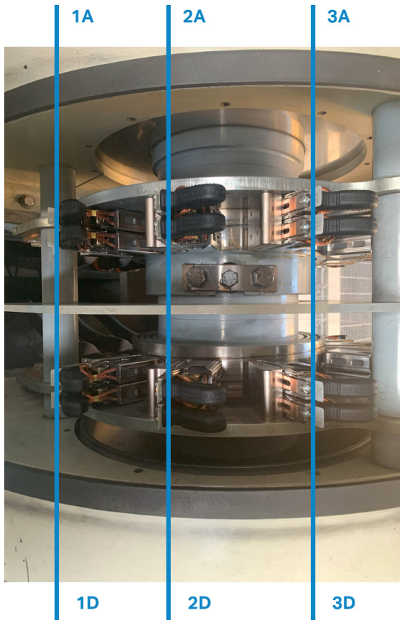
Lateral del generador
