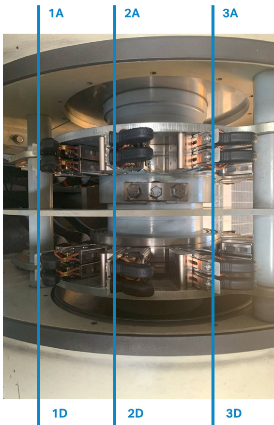
Lateral del generador
