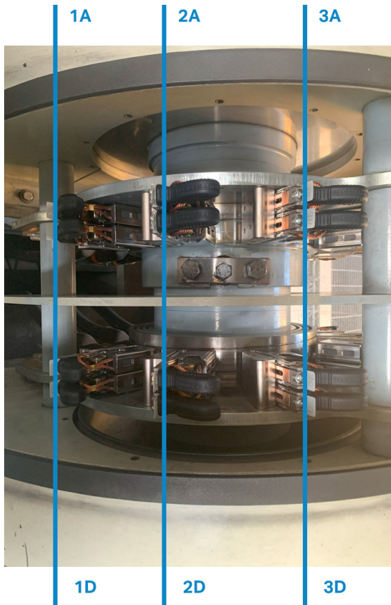
Lateral del generador
